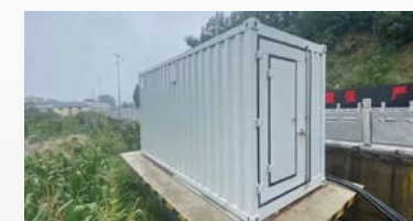
⊗ 智能配电台区
